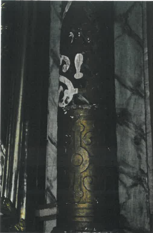
ołtarz południowy. Widoczne zniszczenia kolumn (pasów płótna imitujących relief), a także ubytki złocień i warstwy malarskiej.
