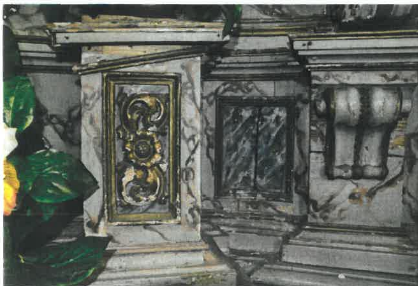
Zniszczenia w ołtarzu bocznym –
